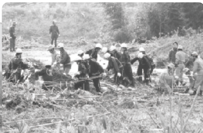
消防団により土砂を除去しての救助
