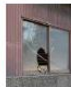
窓が割れた管理不全空家
