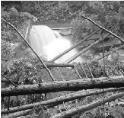
上園の飛行場用水路決壊現場
