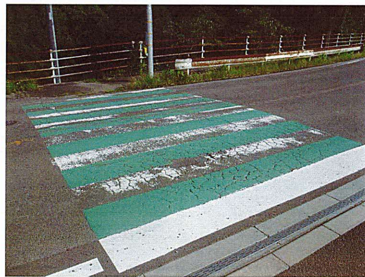
⑦ 商工会前 横断歩道 線が薄くなっている (対策) 状況確認後、予算の範囲内で対応を検討する
