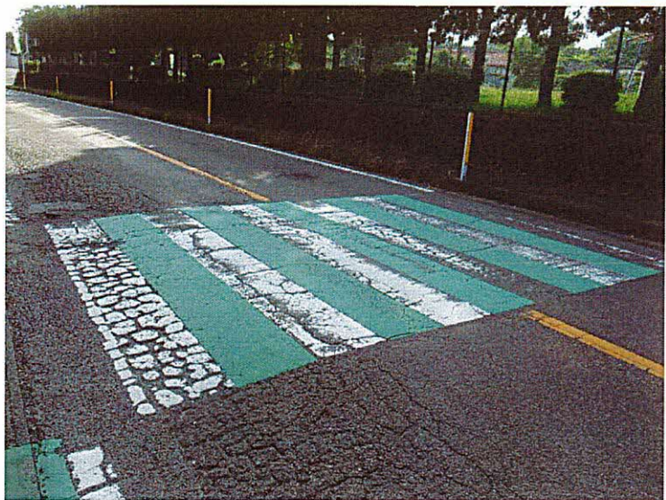
④ 南小正門前横断歩道 線が薄くなっている (対策) 舗装補修工事を発注済みであり、併せて横断歩道、カラー舗装を 施工予定
