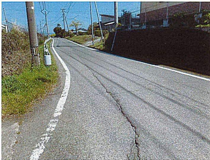
⑫ 新並木 歩道が狭く危険（増田電設付近） (対策) 新設の道路改良の予定があるため、直近での対応が難しい
