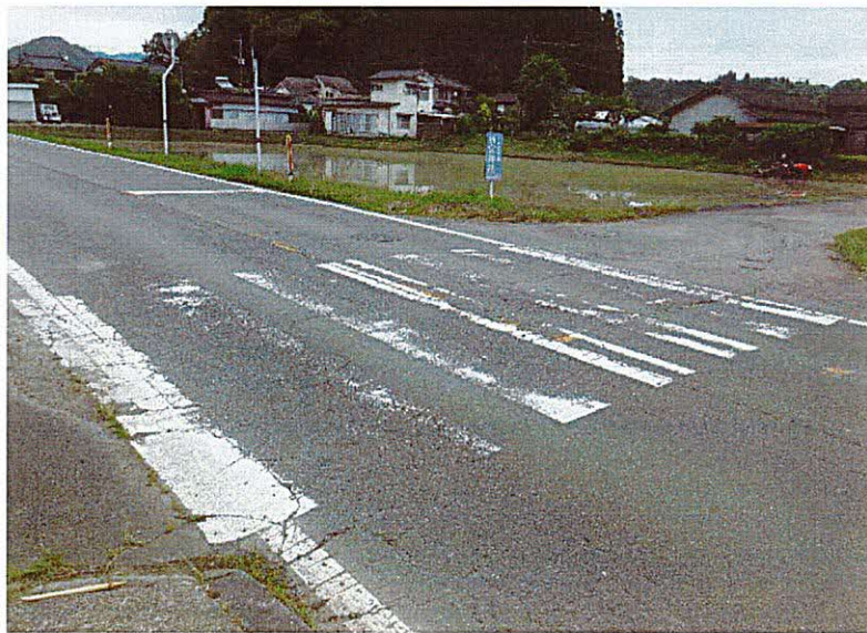
③ 雨宮神社周辺 横断歩道の線が薄くなっている (対策) 状況確認後、予算の範囲内で対応を検討する
