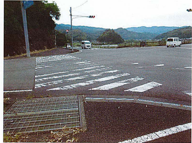
② 相良大橋周辺 横断歩道の線が薄くなっている (対策) 状況確認後、予算の範囲内で対応を検討する
