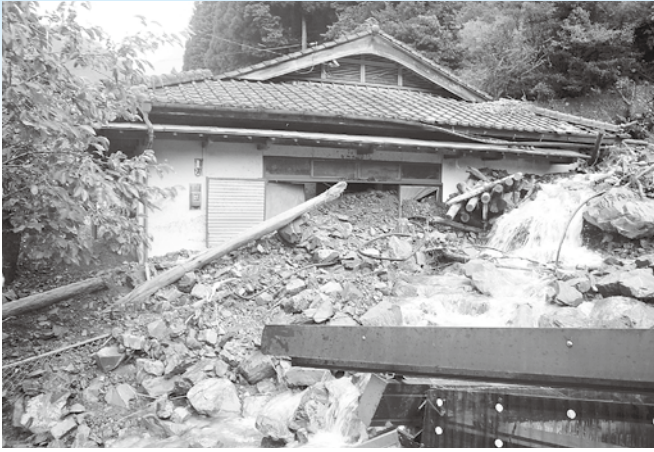
土砂がなだれ込んだ民家(椎葉)
