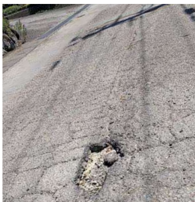
村道山本新村線（新村側）の道路状況
