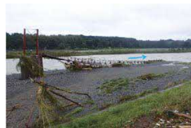
上部工被災状況 (写真①)
