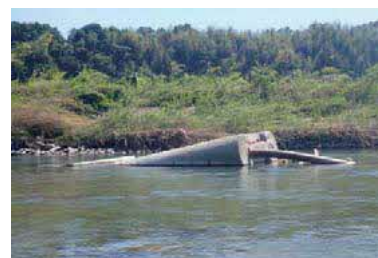
下部工被災状況 (写真②)
