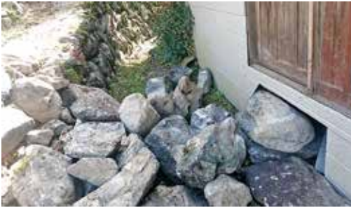
石垣の崩落により家の壁が破損
