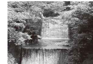
景観に配慮するため、砂防堰堤の表面に間伐材による型枠を用いています。
