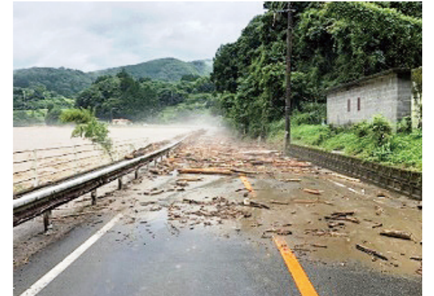
※1 冠水した国道445号
