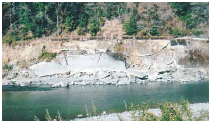
平川・六藤間の災害現場
