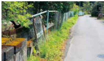
水路の金網の破損
