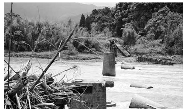
被災したくま川鉄道第4橋梁
