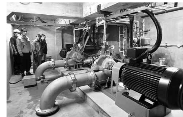
完成した2台の揚水機
