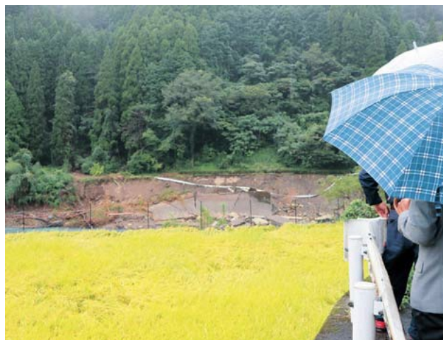
大字四浦西 林業センター対岸：村道の被災
