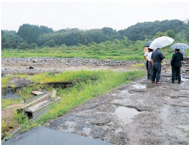
大字深水 字 棚葉瀬：農地と農道の被災
