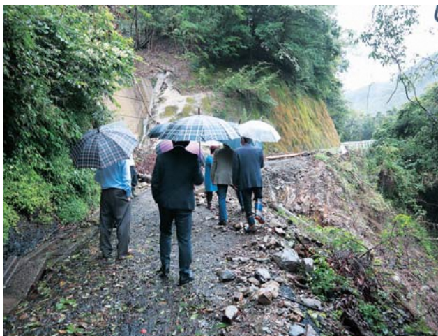
大字四浦東 村道牛駄場山手線：村道の被災
