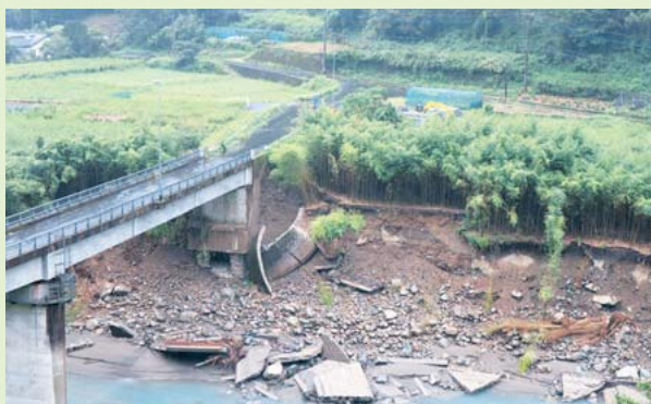
護岸が崩れた新深水橋（四浦）
