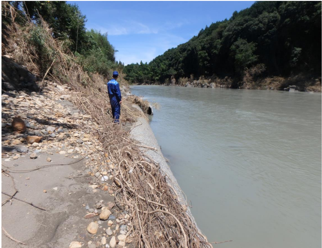
柳瀬＞大曲（水路崩壊）
