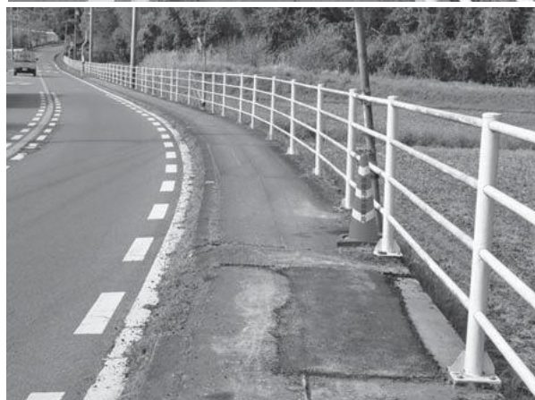
劣化によって生徒が負傷した通学路。今は一部補修されている。 (川辺雨宮神社近く)
