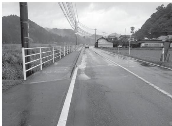
改修を待つ国道445号線
