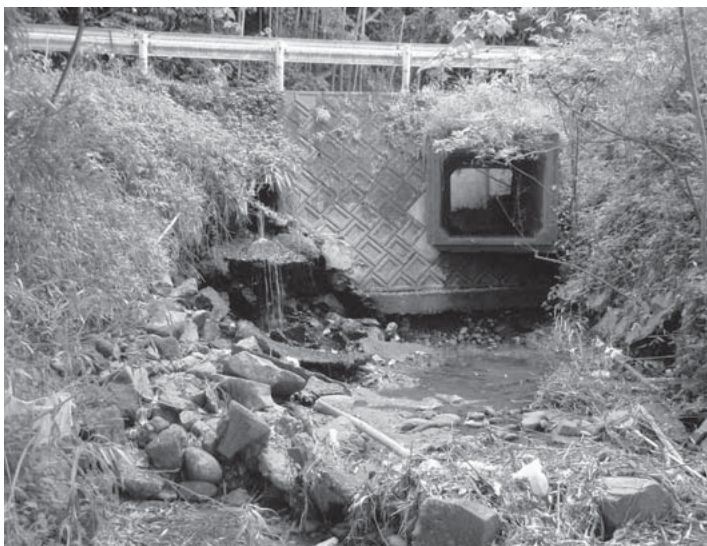
村道前田松馬場線災害状況（上園棚葉瀬間）
