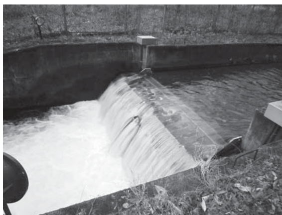
小落差工利用の小水力発電設備
