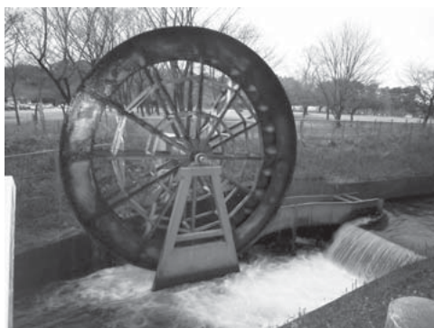
ガラガラ水車(小水力発電設備)
