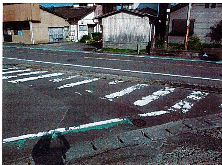
1 3 南小学校プール側横断歩道 線が薄くなっている (対策) 前年度の本会議にて、道路管理者による工事予定を確認したことから、現時点補修については未上申
