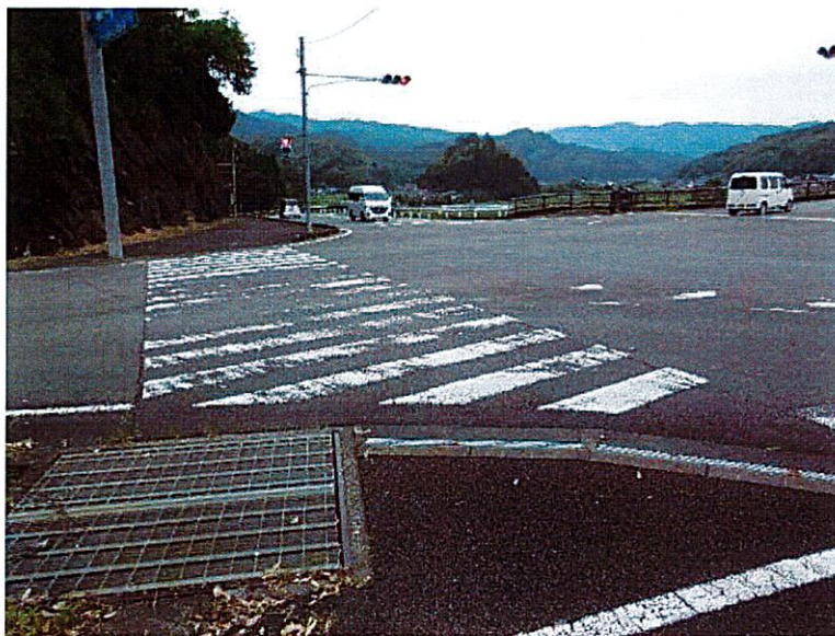
1 1 相良大橋周辺 横断歩道の線が薄くなっている (対策) 舗装要望箇所として上申、対応予定
